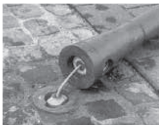
3 | Pollersystem nach der Beschädigung
